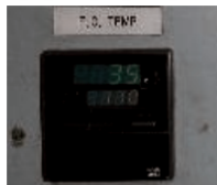
FO Temp. Controller
